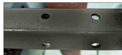
Dura-Coat OX aplicado sobre la corrosión
